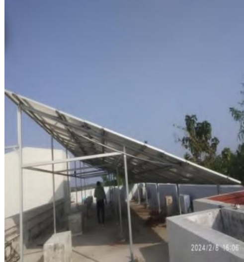
25 KVA Solar Energy
